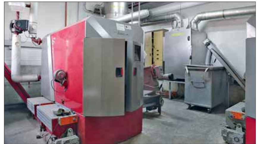
Fast kein Feinstaub: Hackschnitzelkessel mit Feinstaubfilter
