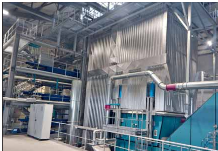
Hochdruckheissdampfkesselanlage mit 22 MW Leistung
