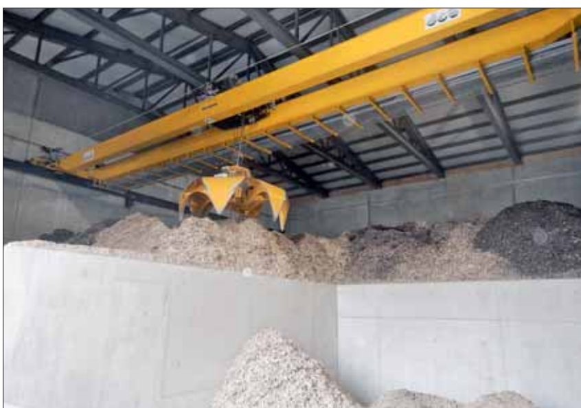
Das Handling der Hackschnitzel erfolgt mit einer Krananlage.
